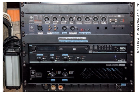
Die Schaltzentrale, der „Mixer“
